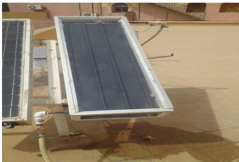
Fig. 8. Capteur thermique hybride (chauffe-eau/air).
